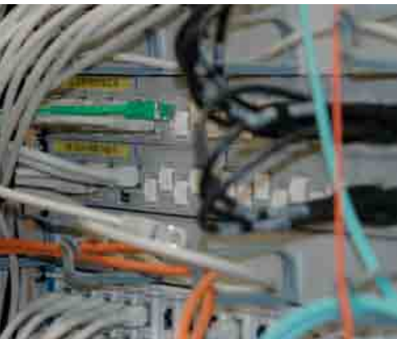
Détail d'une baie de brassage en salle serveur.
