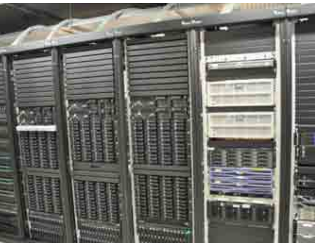
La salle machine 1222-SS-13 et des baies de serveurs de GRIF.
