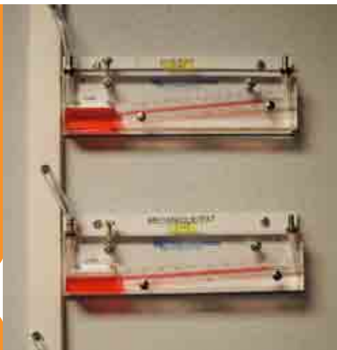
Manomètres à colonnes en entrée de salle propre (suivi des cascades de pression).
