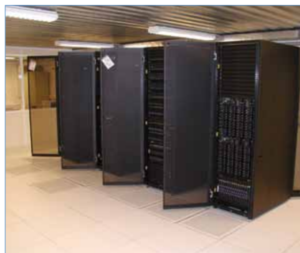
Figure 2 : La salle des machines.
