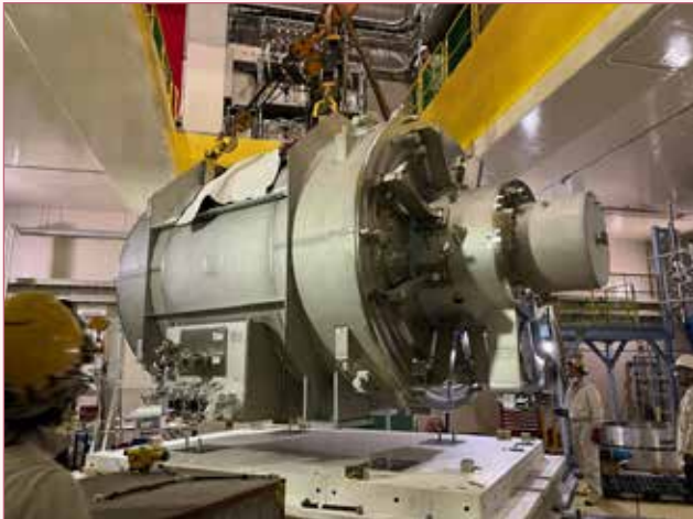
Photo 3 : Le solénoïde du détecteur (DS) est raccordé au solénoïde de liaison (BS) puis descendu dans le hall expérimental de COMET. Il s'agit d'une étape importante franchie par la collaboration COMET.
