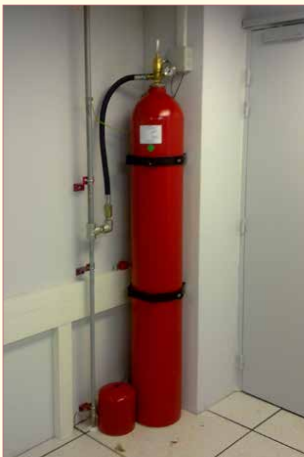
L'une des bouteilles d'argon dans les salles serveurs, assurant un élément de lutte contre les éventuels incendies.
