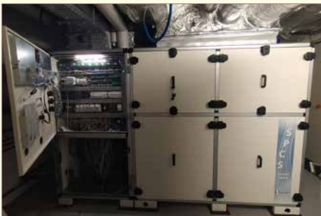
Système de traitement d'air des salles blanches avec son armoire en cours de câblage.
