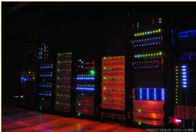
L'une des salles serveurs hébergeant la plateforme PCS-LPNHE.
